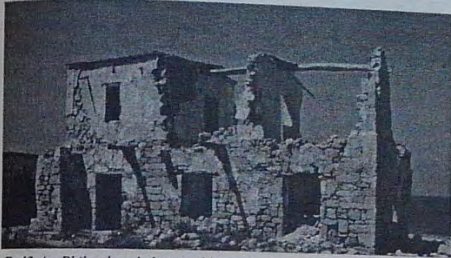
R-43 Ay. Philon harabelerinin dibindeki yıkılma tehlikesi geçiren yapı harabesi
