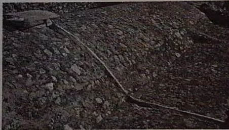
R-28 St. Hilarion kalesinin antik tonozlarının üzerine çimento ile yapılan elektrik tesisatı.
